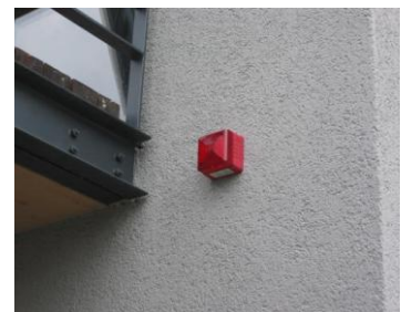
Bild: rote Blitzleuchte oberhalb des Schlüsseldepots zur Kennzeichnung desselben
