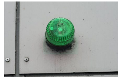
Grüne Blitzleuchte zur Kennzeichnung von Untereinlagen (Zuständigkeitsbereich Brandschutzdienststelle FN)
