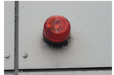
Rote Blitzleuchte oberhalb des Schlüsseldepots zur Kennzeichnung desselben
