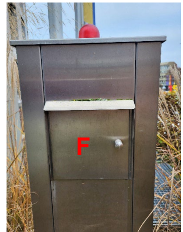
FSD in einer Standsäule mit roter Blitzleuchte
