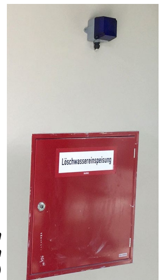
Blaue Blitzleuchte zur Kennzeichnung von Löschwassereinspeisungen (Zuständigkeitsbereich Brandschutzdienststelle Friedrichshafen)
