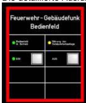
Beispiel eines Feuerwehr-Gebäudefunk-Bedienfeld
