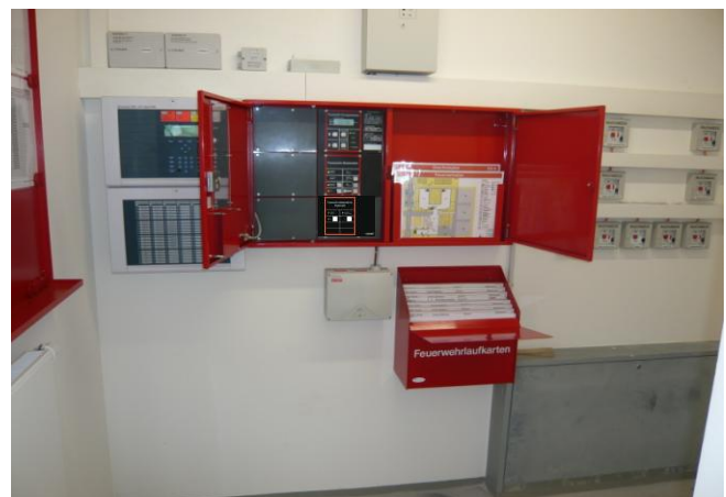
Bild 4.) Feuerwehrraum mit Unterbringung der Brandmelde- Zentrale und Auslösevorrichtungen RWA.
